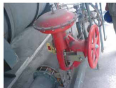
唐山热电厂使用现场
